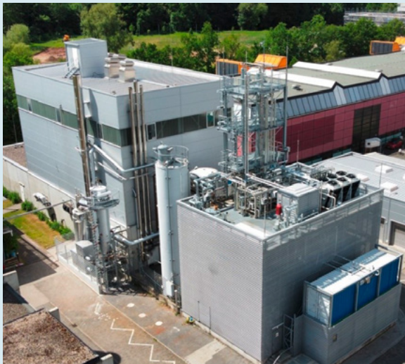
Versuchsanlage der TU Darmstadt, links: Reaktorhalle, rechts: Gasaufbereitungsanlage mit nachgeschaltetem Synthesecontainer.
