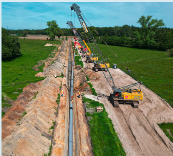
Absenkung eines Rohrabschnitts
