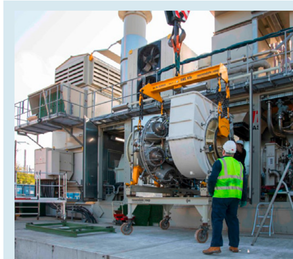
Einbau einer Siemens Energy SGT-400 Gasturbine (10 – 15 MW-Klasse) mit 0 bis 100% H 2 -Verbrennungstechnologie für einen Demonstrationslauf im Rahmen des europäisch-geförderten Projekts HYFLEXPOWER
